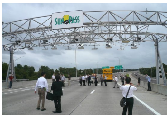
写真-1 供用中のリバーシブルレーン上で撮影 (センサと高解像度カメラのガントリー)
