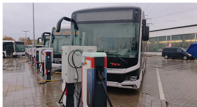
【図-1】電動バスの給電拠点
